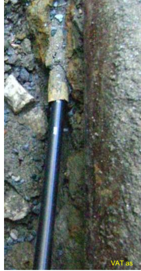
PE-rør i vannledningen:
